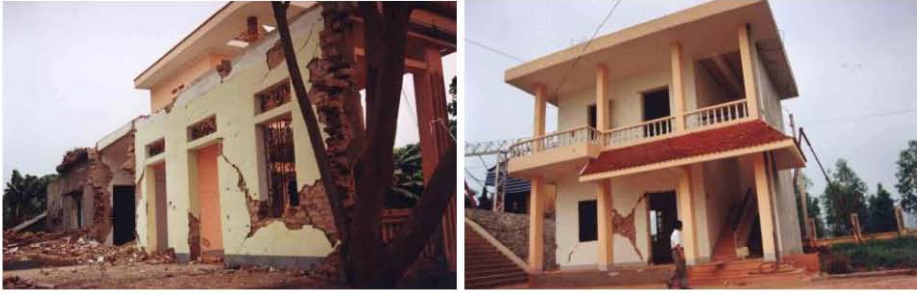
Hình 4.8. Thiệt hại do động đất Thín Tóc tại Điện Biên (2001)
