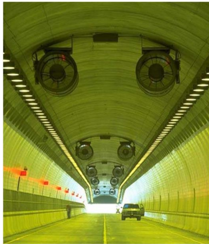
Hình 1. 34. Hệ thống thiết bị trong hầm đường bộ (Mỹ)
